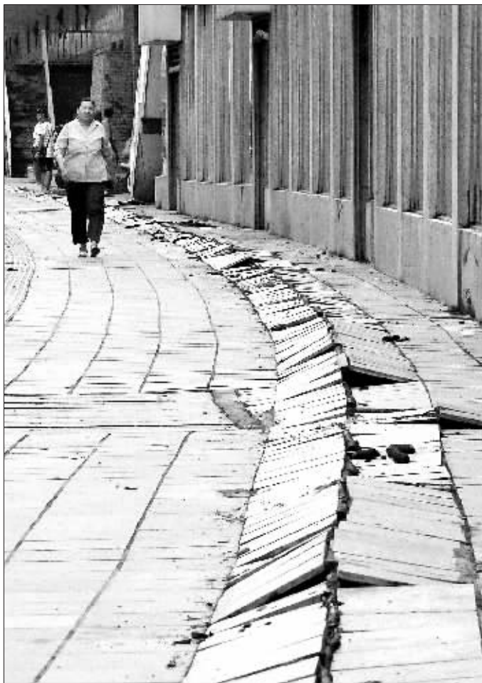
■ 龙母庙附近防洪堤旁路面地砖受挤压拱起。有关专家表示地砖挤压拱起的幅度在允许的安全范围内,市民可以放心。 本报记者 何鏊/摄
